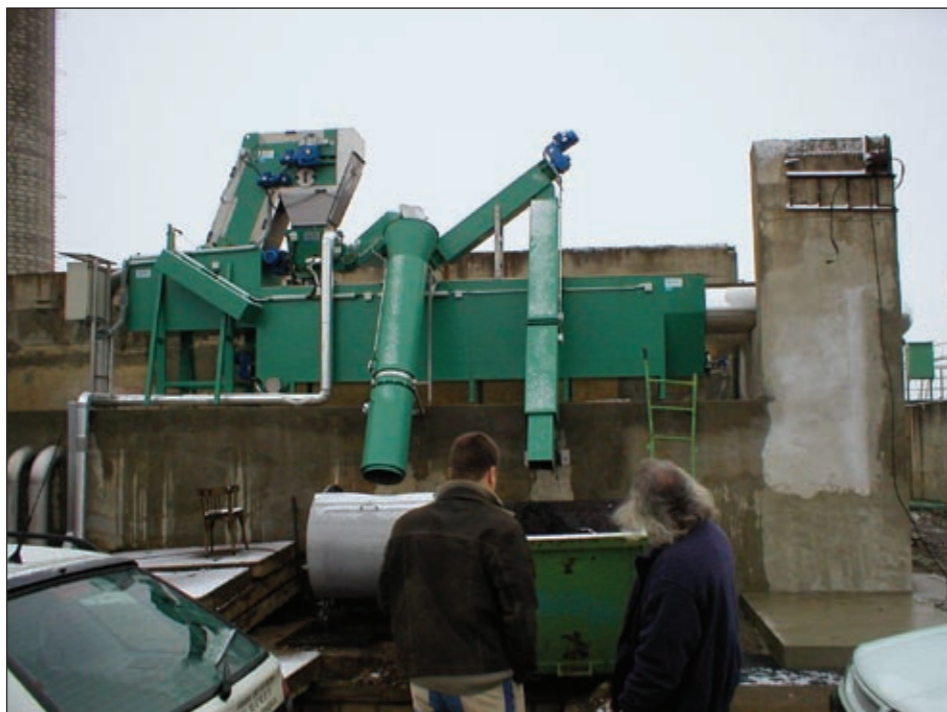
Nová linka hrubého předčištění na ČOV Lutín byla uvedena do provozu na konci listopadu 2006.
