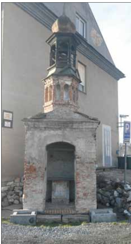
Kaplička před renovací.
