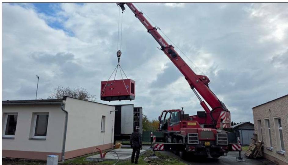
Dieselagregát pro ČOV.
